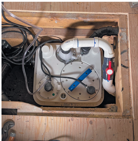
La Sanicubic 1 est installé dans un petit espace sous le plancher de bois de la maison flottante. Adeldo Rodas, PDG et propriétaire de AR Plumbing , et son équipe utilisèrent deux des quatre entrées disponibles sur la Sanicubic 1 .
