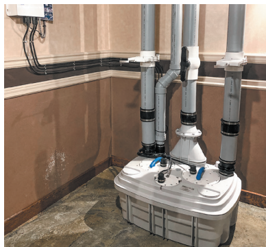
Albanese a installé la Sanicubic 2VX au sous-sol de l'hôtel. Le tuyau d'évacuation de 4 pouces entre l'unité et la conduite d'évacuation principale fait 10,5 pieds à la verticale et 25 pieds à l'horizontale.
