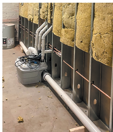
La Sanicubic 2 de Saniflo s'occupe des deux toilettes unisexes au Revival Brewing & Lost Valley Pizza.
