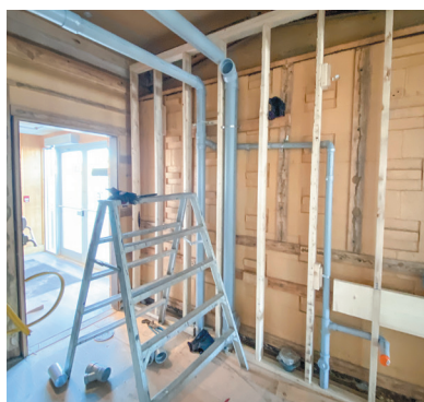
La conduite avec les charges des salles de bain et des sept suites qui se rend à la Sanicubic 2VX.
